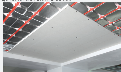
Встановлення і монтаж гіпсокартонних листів на опорній конструкції після випробування під тиском виконується відповідно до діючих правил.
