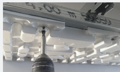
Монтаж і встановлення головних панелей на металевій несучій конструкції за допомогою гвинтів 35 мм
